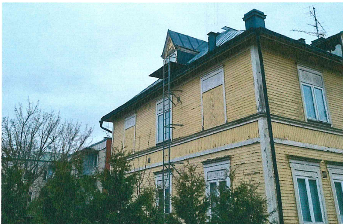
Ovanstående bild tydliggör för dagens utförande av fönsterutrymning med hjälp av stigbrygga för lägenhet nr 1202.
