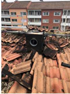
Foto. Brandspridning via ventilation. Källa: Räddningstjänsten
