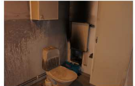
Foto. Brandspridning via schakt. "Källa: Räddningstjänsten"
