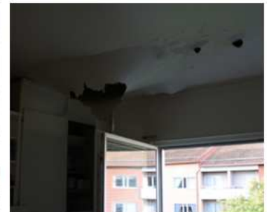
Foto. Vattenskador från släckvatten i bjälklag våning tre. Källa: Räddningstjänsten
