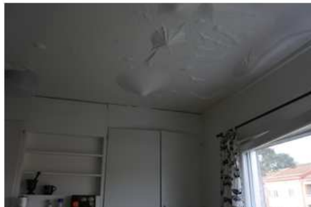
Foto. Vattenskador från släckvatten i bjälklag våning tre. Källa: Räddningstjänsten
