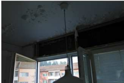
Foto. Brandspridning i bjälklag ovan fönster. "Källa: räddningstjänsten"
